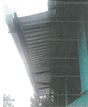
Foto2: Colocación de lámina croquelada y canal, en el frente de la dirección.
